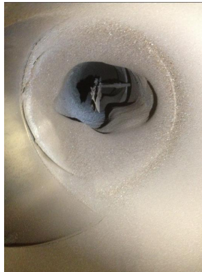
Abscheider im Bereich der Elektrode
