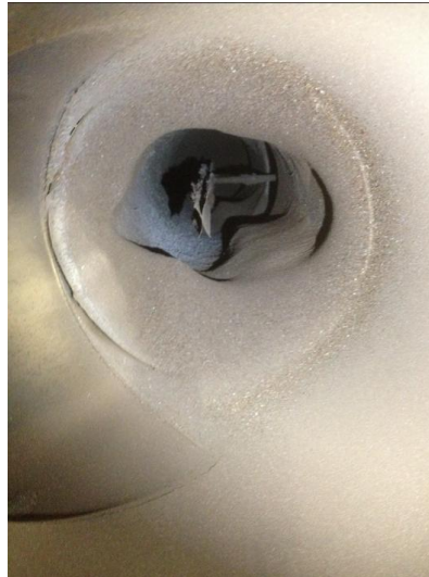
Abscheider im Bereich der Elektrode
